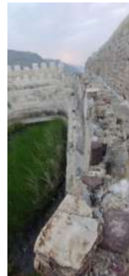
الشكل (27) توضح الصورة وجود تشققات وفراغات بجدران البركة
