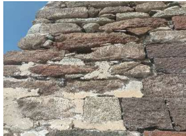
الشكل (11): يوضح تآكل الحجر
