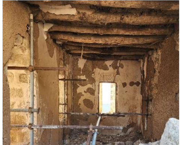
الشكل 12: يوضح الأضرار التي لحقت بالجدران الداخلية للبرج، 2025
