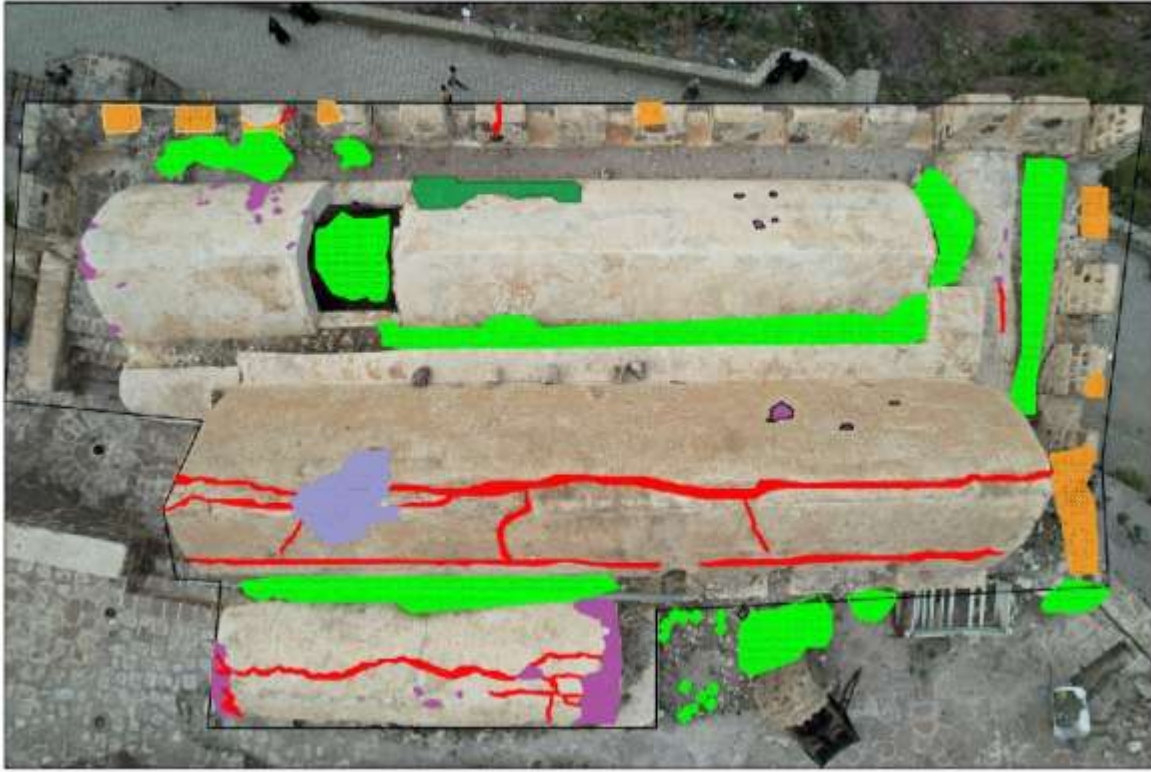
الشكل 13: يوضح الأضرار التي لحقت بالأقبية الأسطوانية للبرج الشمالي.
