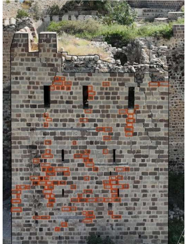
الشكل 14: تظهر الصورة الحجارة المحددة باللون الأحمر لمسارات الرطوبة على الواجهة الغربية.
