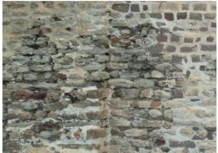
الشكل 8: تآكل وتفتت الحجارة وتآكل ملاط الربط على الواجهة الشمالية للبرج.
