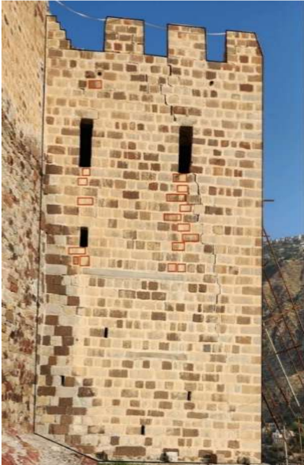
الشكل 15: تظهر الصورة الحجارة المحددة باللون الأحمر لمسارات الرطوبة على الواجهة الشمالية.
