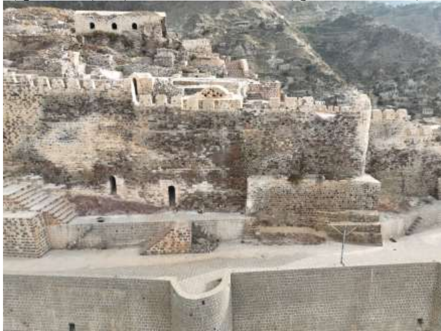
الشكل (22) توضح الصورة ظهور الاملاح على جدران القلعة بسبب انسداد لبعض تصارييف المياه في القلعة وذلك نتيجة للنزاع المسلحة الصورة بتاريخ (2025)
