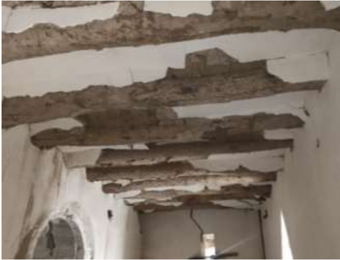
الشكل 13: يوضح الأضرار التي لحقت بالسقف الداخلي للبرج، 2025
