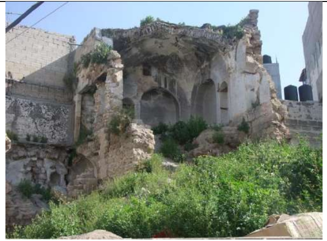
صور أضرار البيوت الأثرية - البلدة القديمة غزة
